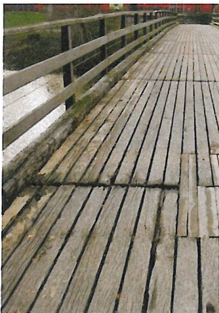
Brückenbelag aus Holz vor Instandsetzung.
